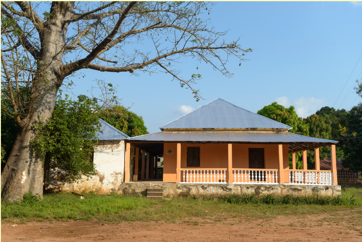
Une maison en cours de rénovation à Canchungo dans le cadre d'un programme du Grdr, financé par la Fondation Abbé-Pierre, réalisé grâce à un partenariat avec CRAterre
