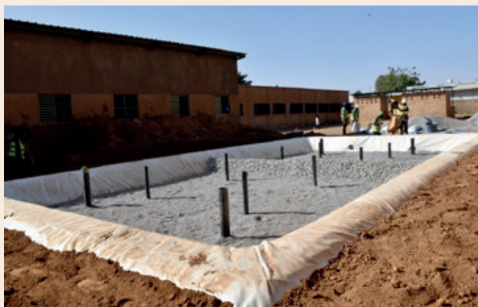
Dispositif de filtre planté implanté à Bakel
