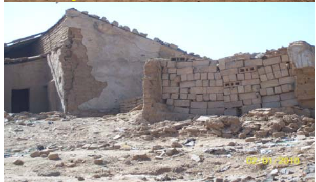
Dégâts sur les habitations
